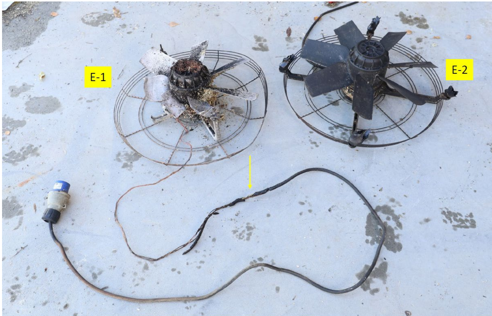
Fig. 16: Viser den brente vifta E-1 til venstre. Pila viser til ledningen hvor det nærmest vifta ses blottlagte ledere grunnet smeltet og bortbrent isolasjon. På ledningen nærmest støpselet var isolasjonen intakt. Til høyre er vifta E-2, som var av samme type som E-1. E-2 var sotet og hadde mindre smelteskader.
