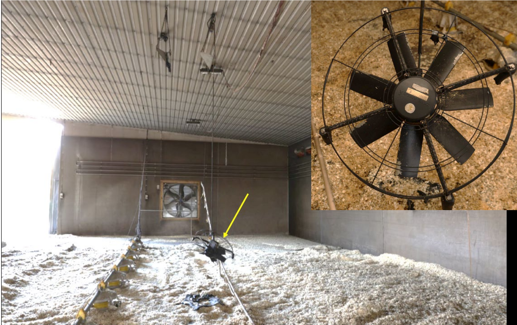
Fig. 14: Viser nordvestre del av dyrerommet. Pila viser til vifta E-2 hengende like over gulvet. Festet av plast i takmonteringen hadde smeltet, slik at vifta hadde falt et stykke, og hadde deretter blitt hengende i ledningen.
